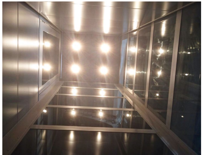
Offener Schacht ohne Kabine
